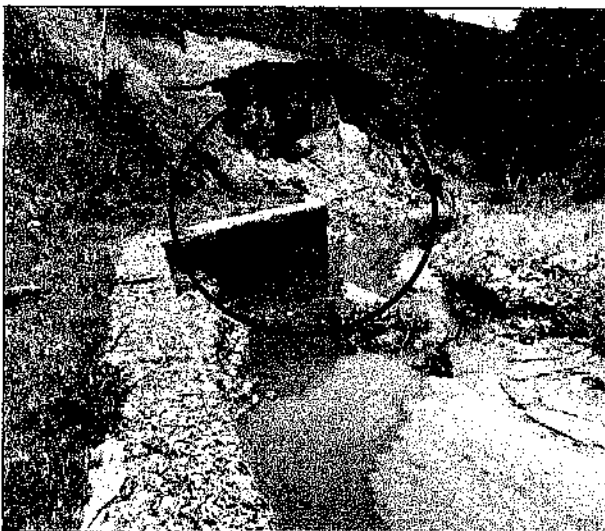
Figura 5. Detalhe do muro gabião antes do tombamento.
