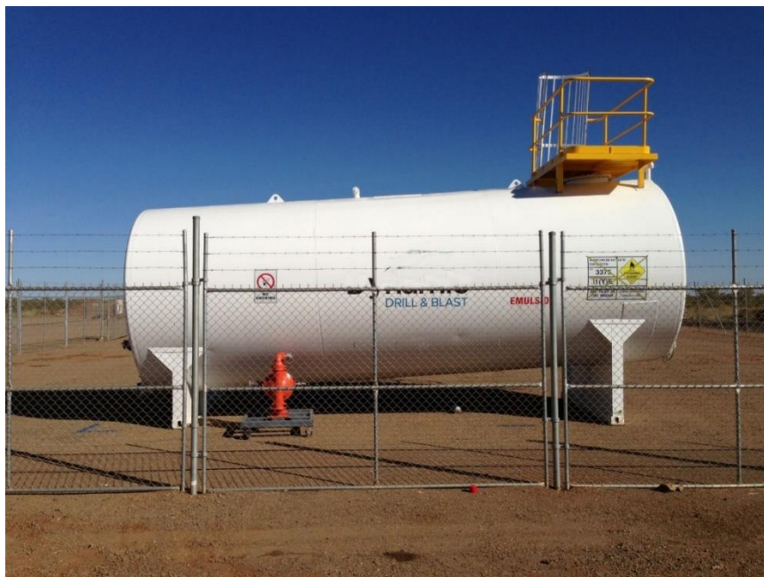
Figura 2.4.2-38 - Armazenamento de emulsão encartuchada - isotanque.
