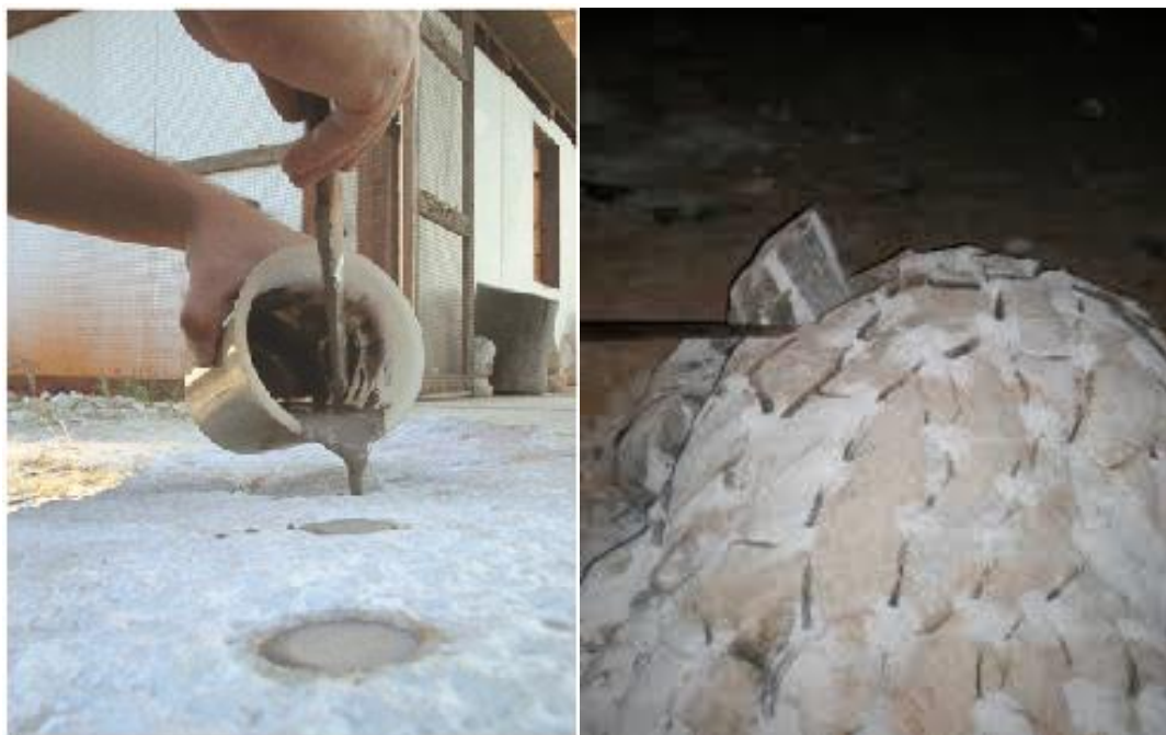
Figura 3.2.2-1 - À esquerda, preenchimento dos furos com argamassa expansiva; à direita, rocha fragmentada por argamassa expansiva
