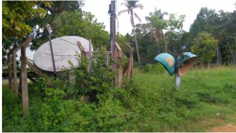
Estrutura de Telecomunicação Ponto 3
