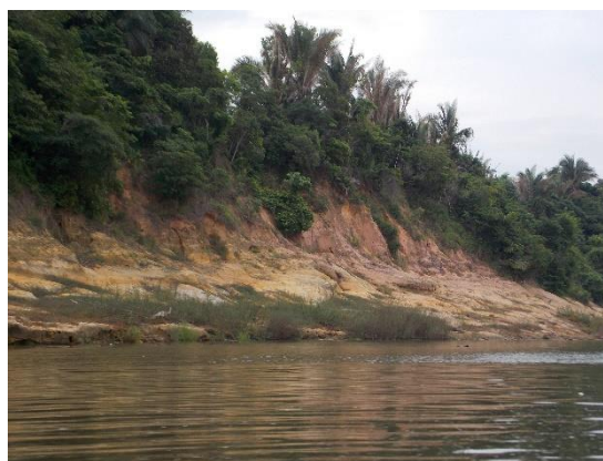
Foto 5.1.4-52 - Margem erosiva sustentada por arenitos arcoseanos estratificados, grossos a conglomeráticos e níveis de pelitos do Grupo Itapecuru, que quando alterados e erodidos evidenciam o leito maior do rio (0703398 x9407879).
