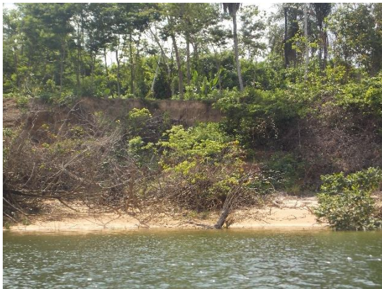
Foto 5.1.4-93 - Desmoronamentos de margem de Planície de inundação, expondo o dique marginal elevado sobre a planície que foi limpo para plantio de roça. (0648405x9596535).
