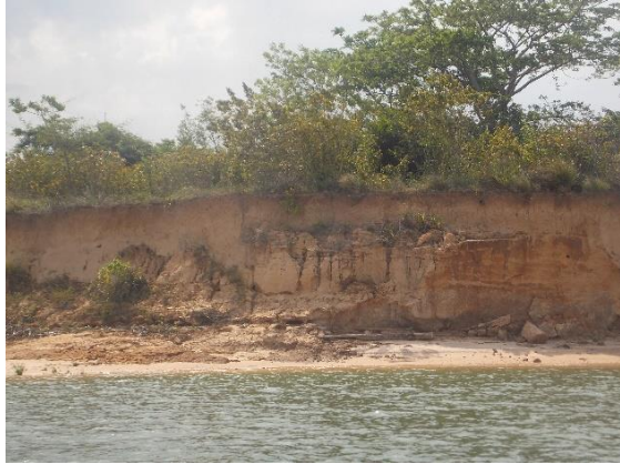
Foto 5.1.4-127 - Solapamento e pequenos escorregamentos que afetam margens em planície de inundação (0648775x9657425).
