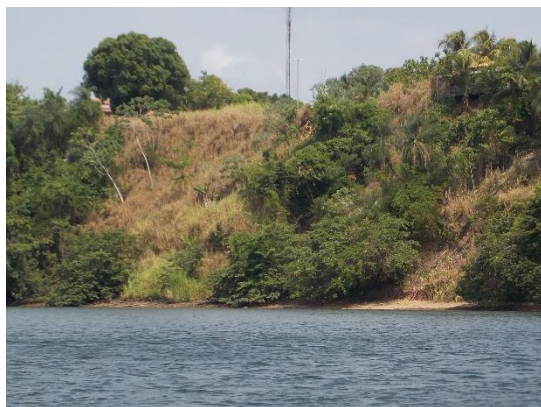
Foto 5.1.4-114 - Trecho da escarpa em Baião com amplitude de 25 a 30 m, com processos de rastejo e pequenos escorregamentos que afetam a base do muro da casa no alto da escarpa (0647410 x 9691307).
