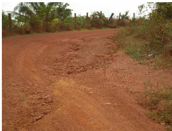
Foto 5.1.4-44 - Erosão laminar e em sulcos ocasionais de média intensidade nas estradas que cortam o relevo de Morros na margem esquerda do Rio Tocantins (0633378x9604997).
