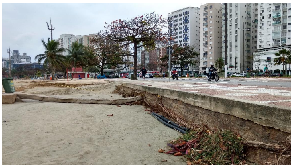
Figura 2-83. Forte processo erosivo entre os perfis STOS21 e STOS22 com interdição de acesso. Na foto estão apresentadas as condições em Agosto de 2016.
