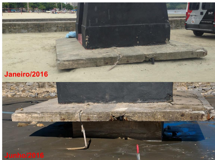
Figura 2-79. Forte processo erosivo na base do farol junto ao perfil STOS20. Na foto estão apresentadas as condições em Janeiro de 2016 e Junho de 2016.
