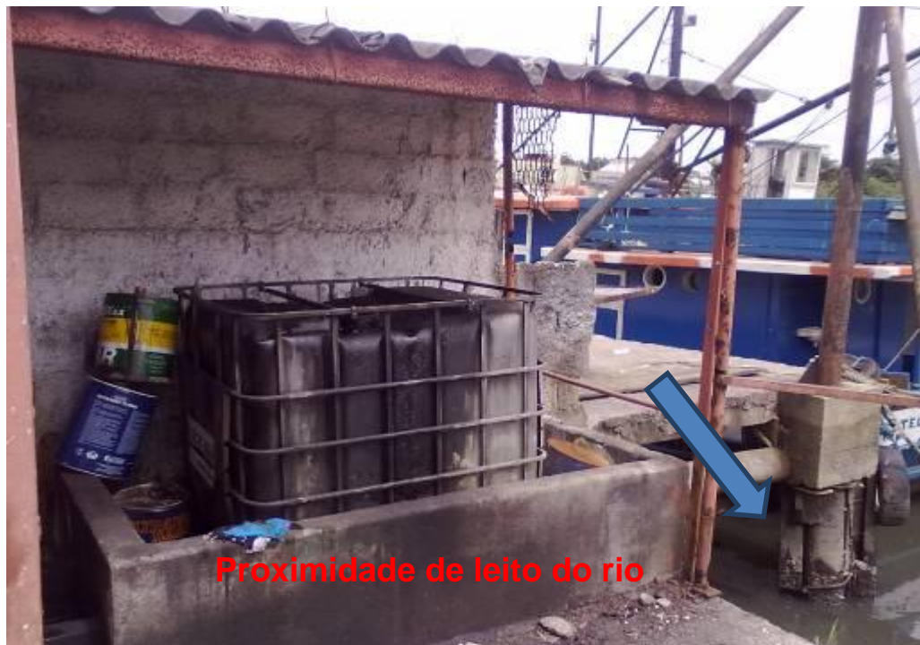
Figura 22.3.2.3.2.1.1-3. Proximidade do tanque de coleta de óleo usado ao leito do rio – Terminal Itafish. Autor: Marcos Silveira
