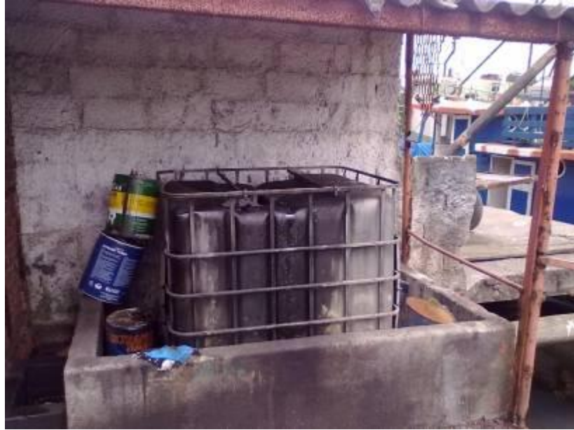
Figura 22.3.2.3.2.1.1-2. Tanque coletor para coleta de óleo usado – Terminal Itafish. Autor: Marcos Silveira.
