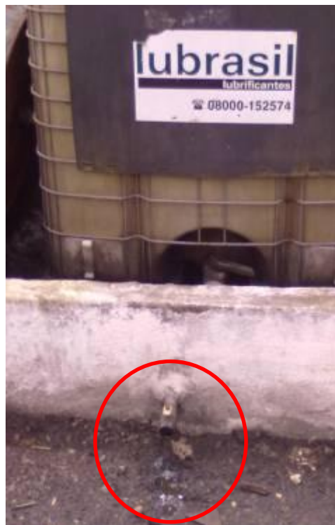
Figura 22.3.2.3.2.1.1-6. Dreno da bacia de contenção do tanque de coleta de óleo usado instalado pela empresa Lubrasil no Terminal Aliança. É possível visualizar gotejamento constante de líquido da caixa de contenção. Autor: Marcos Silveira.
