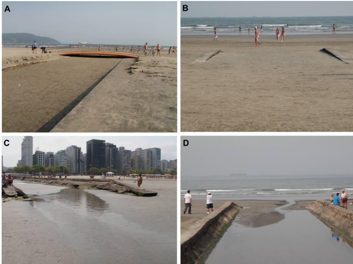
Figura 8.3.2.3-10. A e B (Canal 2): intenso assoreamento no interior do canal e assimetria no empilhamento de areias nas laterais do canal/estirâncio, provocando o soterramento do mesmo. C (Canal 1): assoreamento no interior do canal e migração lateral do canal de drenagem para W. D (Canal 3): assoreamento no interior do canal, migração da barra de desembocadura e do canal de drenagem para W (em 13 de setembro de 2010).
