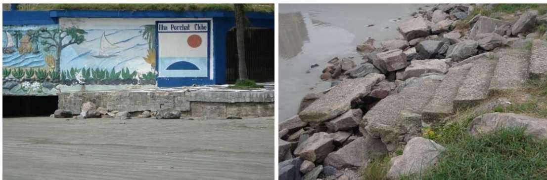
Figura 8.3.2.2-8. Descalçamento de estruturas nas proximidades dos perfis Itar-01 (base do calçamento da Ilha Porchat Clube – em 13 de outubro de 2010) e Stos-02 (escada lateral do espigão do Emissário destruída - em 15 de setembro de 2010).
