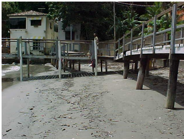
Figura 4.8.3.4-9. Indicadores de erosão I (pós-praia quase inexistente na maré de quadratura e inexistente na maré de sizígia) e II (retrogradação ou recuo da linha de costa e migração vertical do perfil praial). Notar o empilhamento de areia no local, provocando o soterramento das pilastras da ponte de acesso ao cais. Local dos perfis Góes-04 e Góes 05 (data: 07/03/2010).
