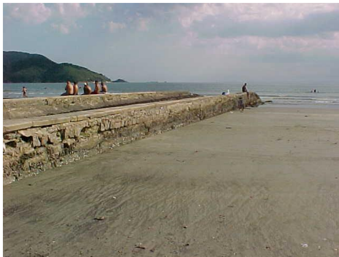
Figura 4.8.3.4-5. Indicador de erosão VIII (erosão/destruição de estruturas artificiais construídas na praia e redução do estoque de areia). Local do perfil Stos-17, na raiz do Canal 5 (data: 22/02/2010).
