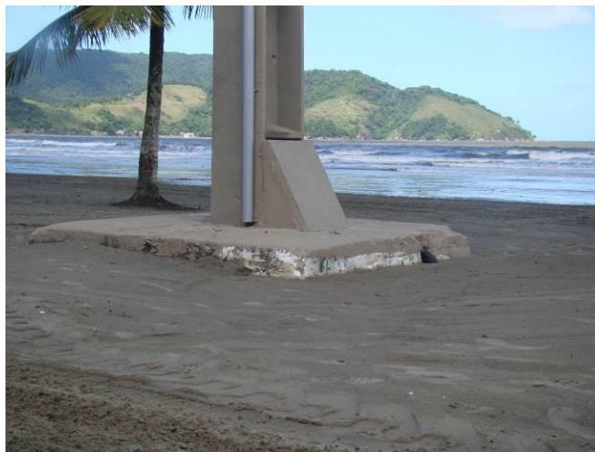
Figura 4.8.3.4-7. Indicador de VIII (erosão/destruição de estruturas artificiais construídas na praia e redução do estoque de areia – base do poste do holofote exposta). Local do perfil Stos-19 (Boqueirão) (data: 06/04/2010).
