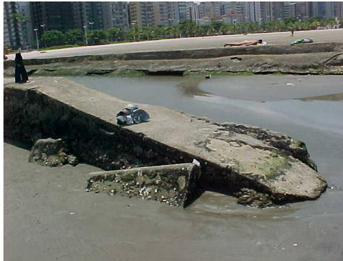
Figura 4.8.3.4-4. Indicador de erosão VIII (erosão/destruição de estruturas artificiais construídas na praia). Local do perfil Stos-05, na raiz do Canal 2 (data: 22/02/2010).
