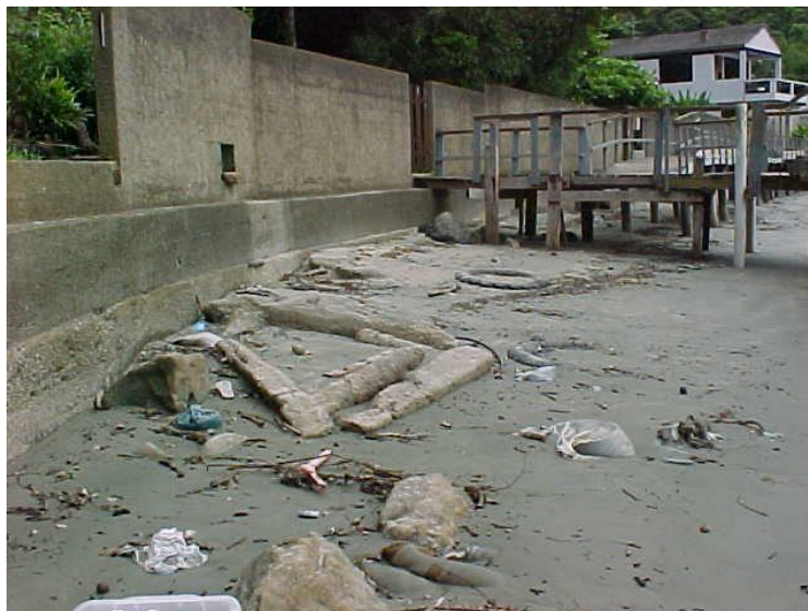
Figura 4.8.3.4-12. Detalhe da foto anterior mostrando restos de estruturas erodidas e de sacos de areia soterrados utilizados em alguma época para tentar conter a erosão (inutilmente). Local do perfil Góes-04 (data: 20/02/2010).
