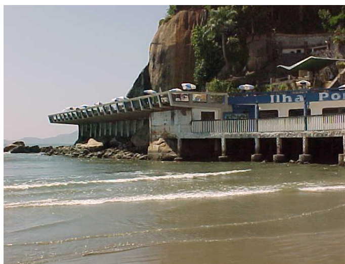
Figura 4.8.3.4-1. Indicador de erosão VIII (erosão/destruição de estruturas artificiais construídas próximas à praia). Local do perfil Itararé-01 (data: 21/02/2010).
