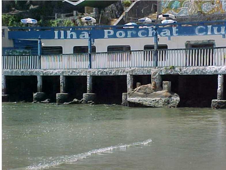
Figura 4.8.3.4-2. Detalhe da foto anterior mostrando a erosão e a redução do estoque de areia, com exposição da base dessas antigas pilastras da ponte que margeia o Clube da Ilha Porchat. Local do perfil Itararé-01 (data: 21/02/2010).
