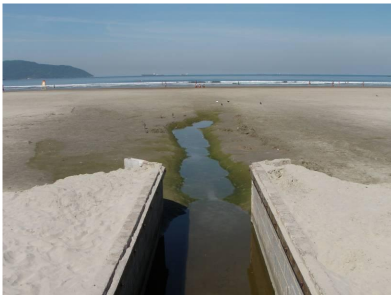
Figura 4.8.3.6-7. Assoreamento de canal de drenagem natural e artificial (Itar-02/5ª).
