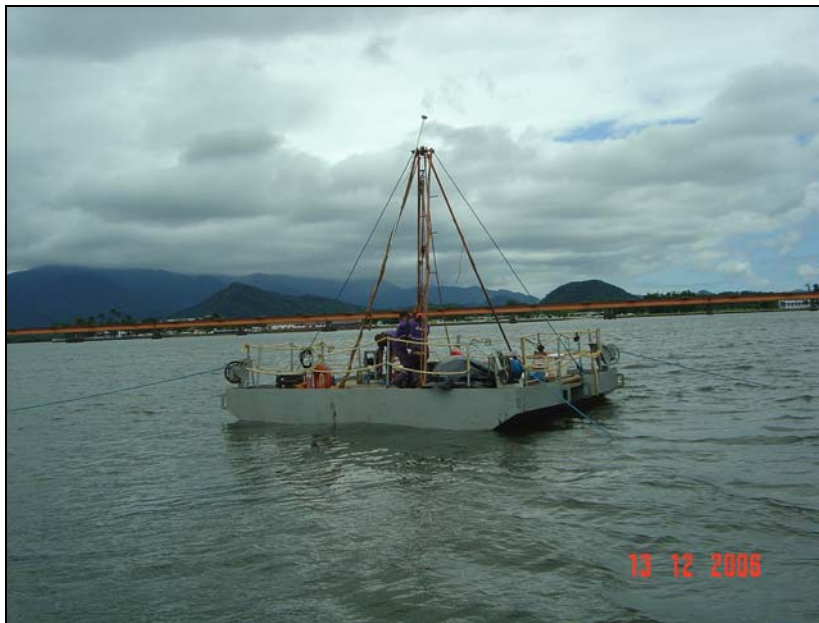
Figura 51: Sondagem a percussão em andamento, nas proximidades da Ponte Ferroviária, no canal interno do Porto de Santos.
