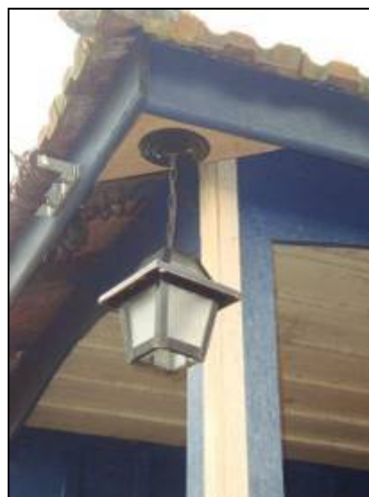
Detalhe da luminária externa da varanda.
