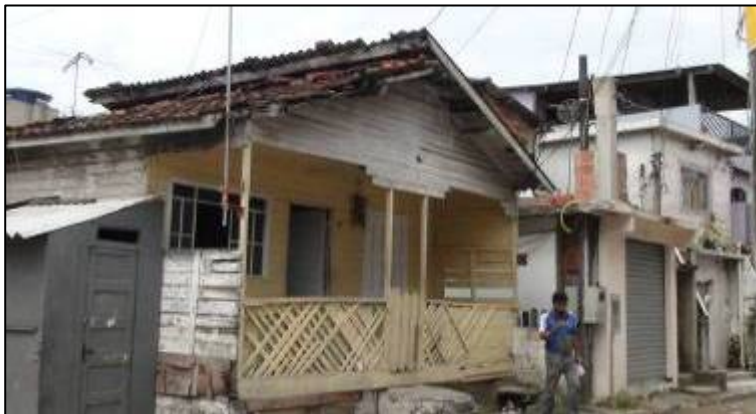
Única casa de tipologia caiçara identificada em Santa Cruz dos Navegantes, encontrando-se em mau estado de conservação.
