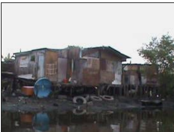
Vista dos fundos das palafitas para o Mangue (Rio da Pouca Saúde). Unidades totalmente geminadas.
