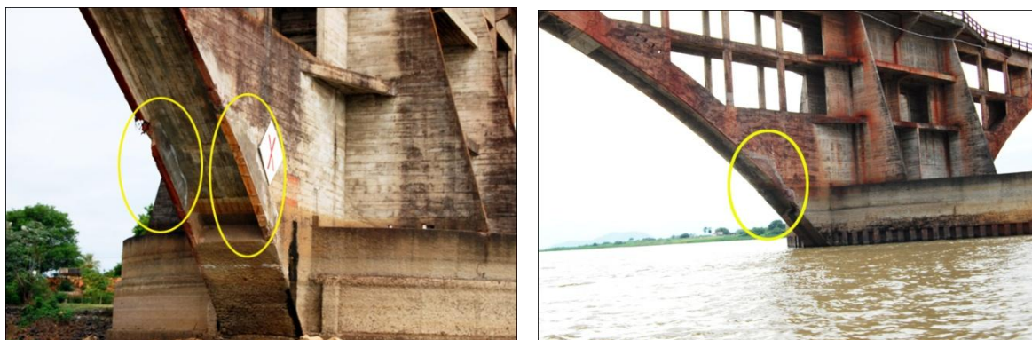
FIGURA 5.3.195 – MARCAS DE IMPACTO DE BARCAÇAS NAS ESTRUTURAS DA PONTE FONTE: Os Autores (2010)
