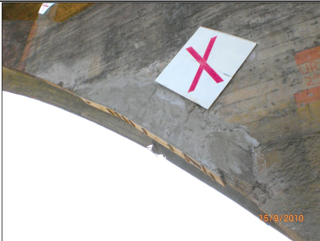
FIGURA 2.1.16 - DETALHE DE REPARO NO ARCO DA PONTE CAUSADO POR COLISÃO DE EMBARCAÇÃO FONTE: Os Autores (2010)
