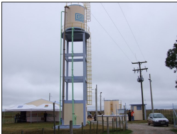
Figura 151 - Estação de Tratamento de Água - Santa Isabel do Sul - Arroio Grande. Fonte: Autores (19/11/2012).
