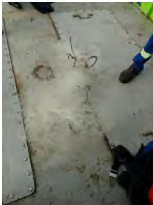
Figura 2: Rede encontrada na estrutura do equipamento na estação fixa #506.
