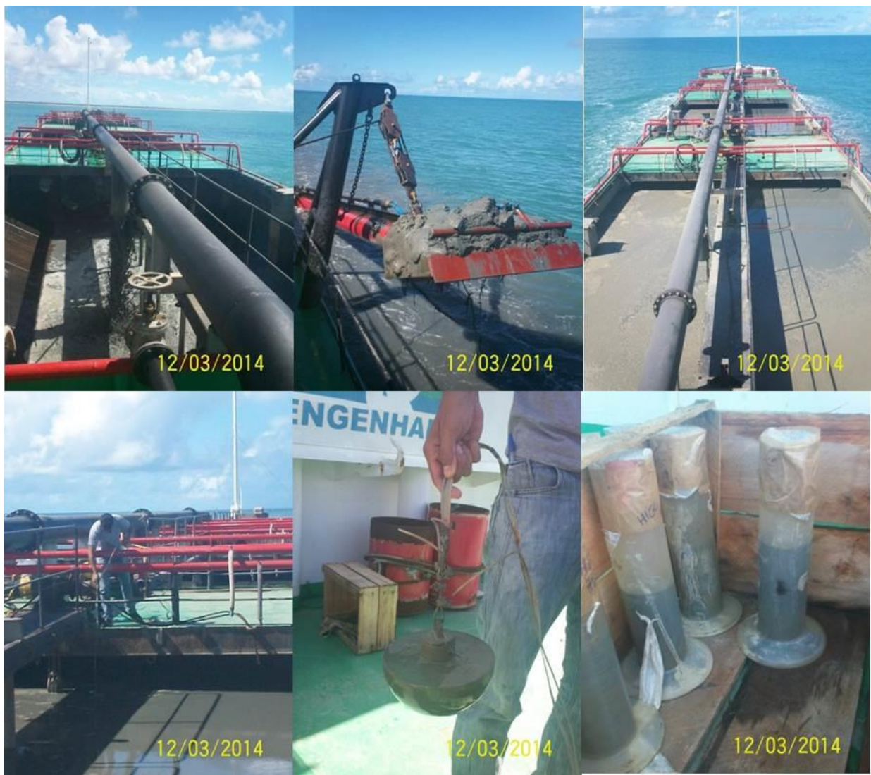
Figura 24. Dragagem Rio Ibicuí, utilizada na obra de dragagem no canal de acesso ao terminal de barcas da Fibria em Caravelas. Detalhe do braço de sucção e da cisterna cheia e da medição das cisternas com o peso de prumo e taxa de sobrenadante.
