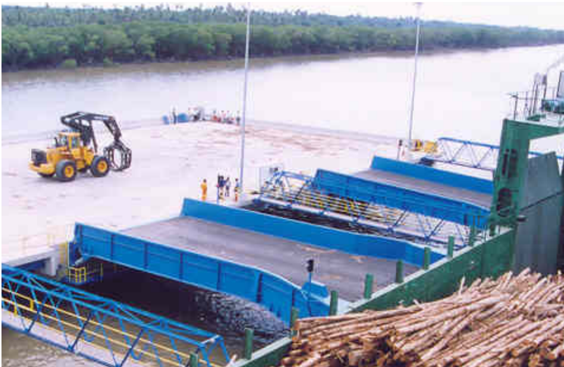
Figura 3.5.2-1 – Linkspan (ponte de acesso metálica) e máquina carregadeira estacionada na plataforma no Terminal de Caravelas
