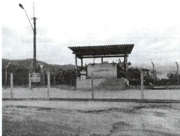
Figura 45 - Tanque de armazenamento de diesel
