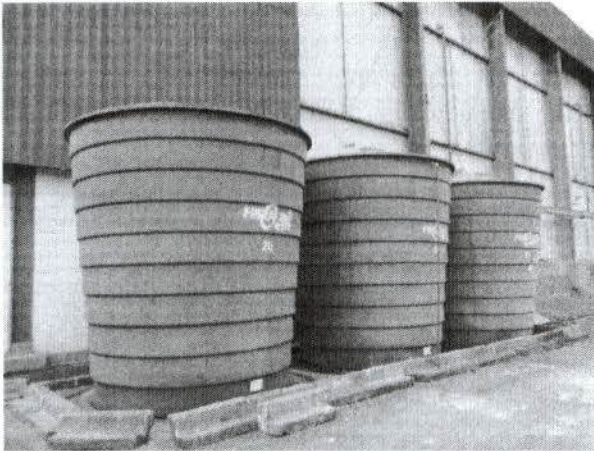
Figura 54 – Tanques de armazenamento de água da chuva
