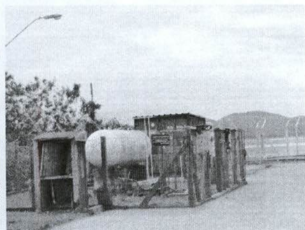
Figura 49 – Tanque de armazenamento de GLP
