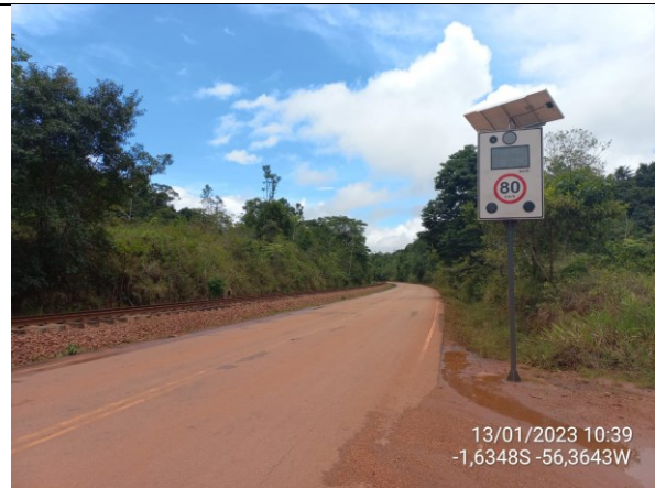
Figura 3.7 - 10 Lombada eletrônica instalada, com velocidade da via.
